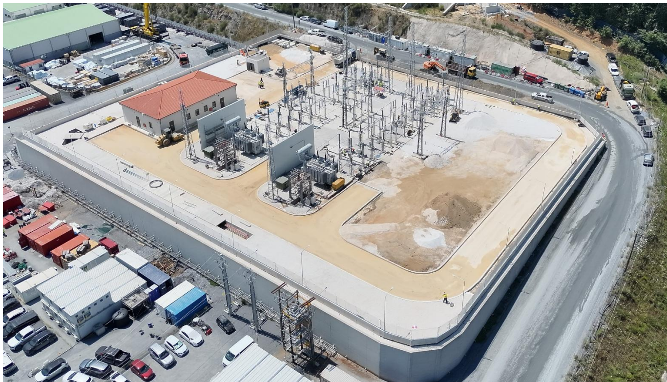
Υποσταθμός της μονάδας επεξεργασίας
